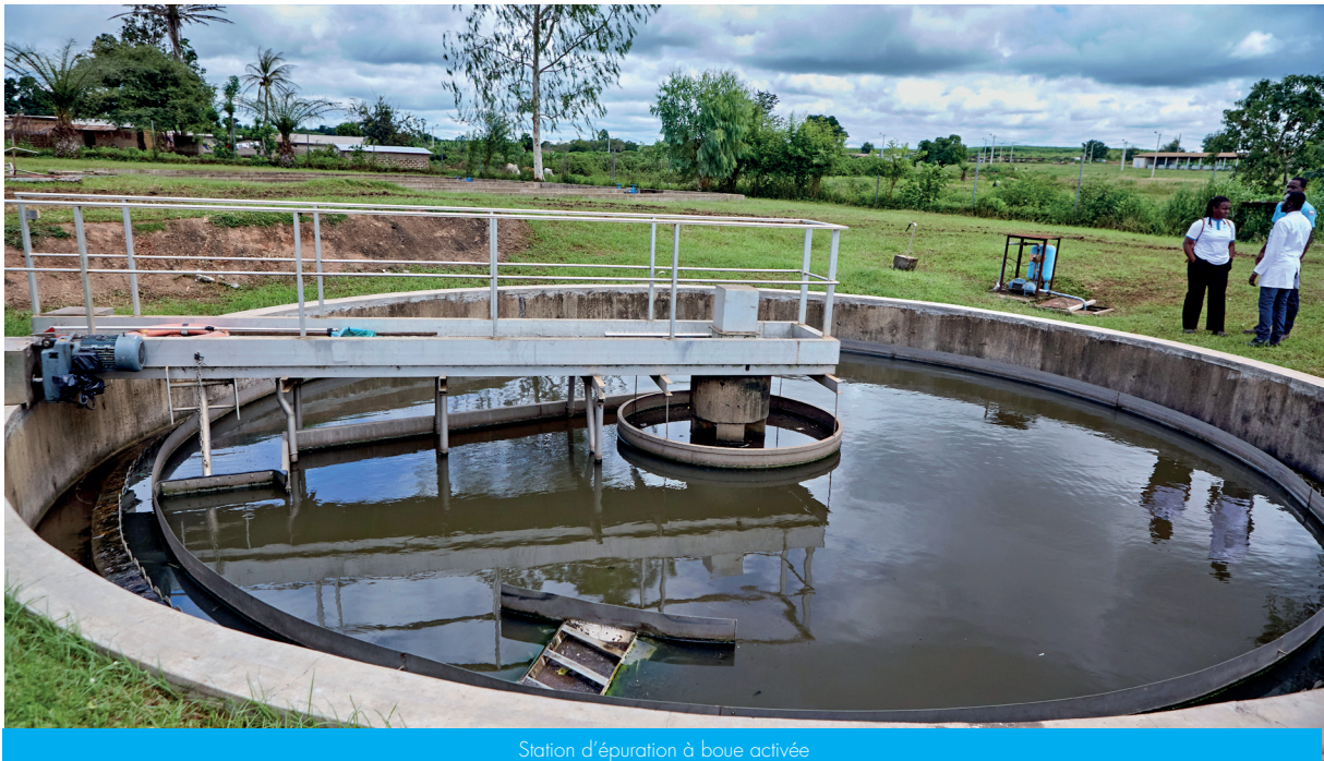
Station d'épuration à boue activée
